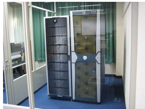
(b) サーバルーム
