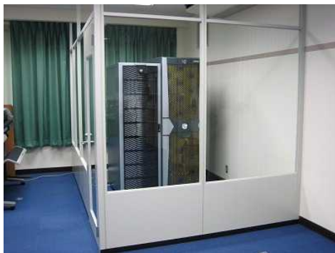
(a) サーバルーム
