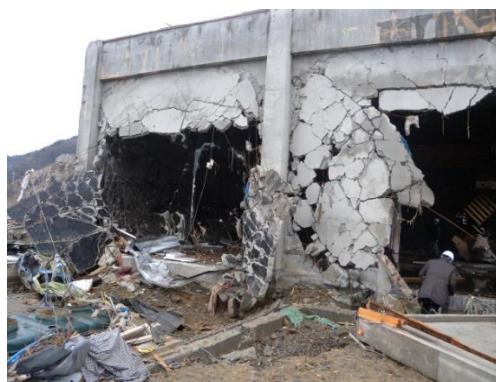
写真-2 コンクリート壁の被害
